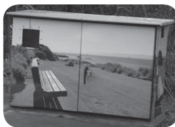
Wrapped electrical kiosk
